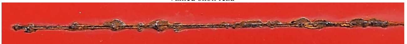
Delaminace nátěru v okolí řezu
