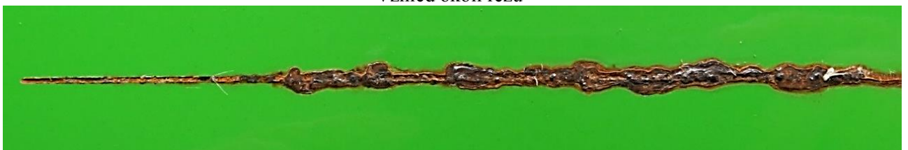
Delaminace nátěru v okolí řezu
