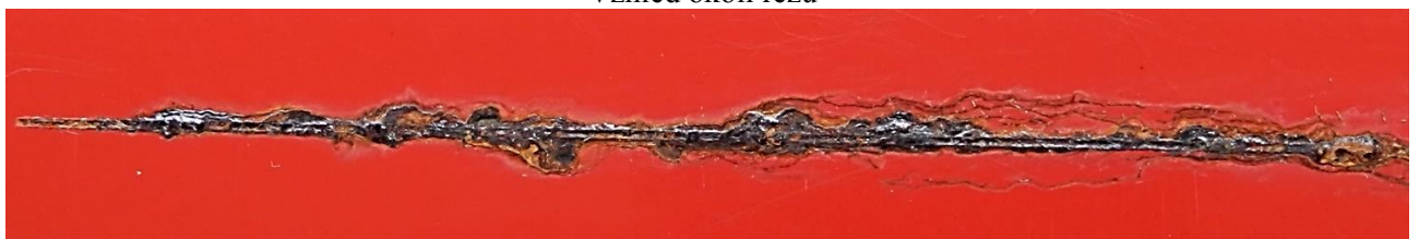
Delaminace nátěru v okolí řezu
