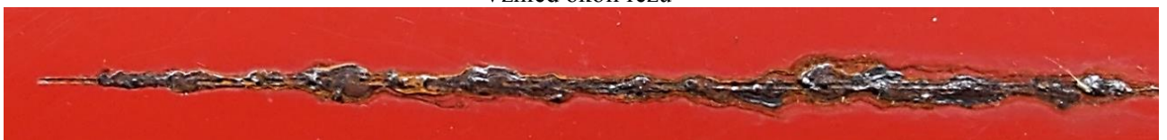
Delaminace nátěru v okolí řezu
